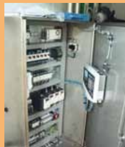
L'armoire de contrôle déportée (dans un local spécifique) gère lignes et alarmes.
