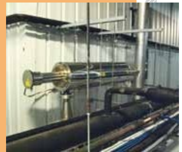
Installation de transformation catalytique de l' O_3 résiduel en O_2 dans le plénum.
