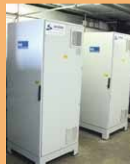
Deux équipements de production d'ozone (séparation de l'oxygène de l'air et transformation par voie plasma de l' O_2 en O_3 ).
